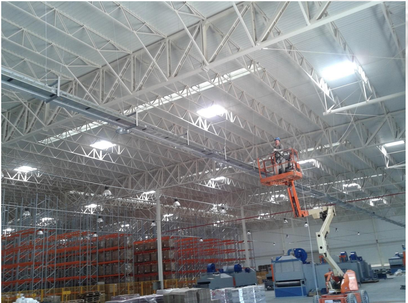
Linha de barramento blindado linha BF sendo instalado em área industrial
